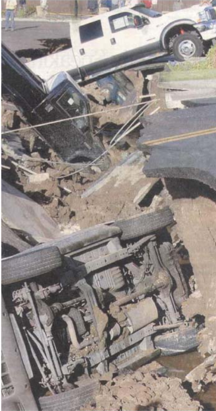
FIGURE 3 : Affaissement de la chaussée à Bakersfield, Californie
