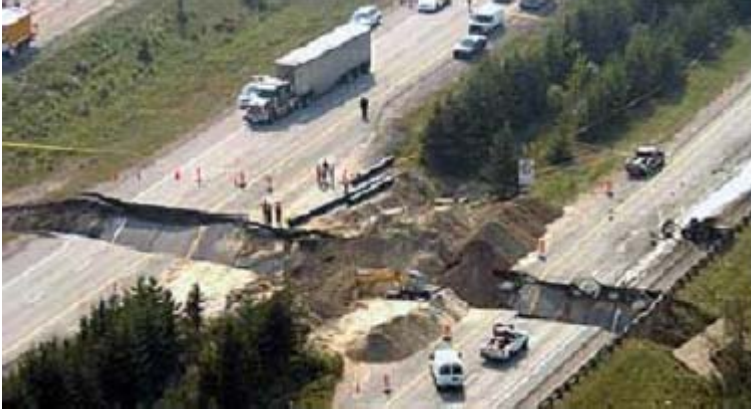
FIGURE 5 : Affaissement de la chaussée de l'autoroute 40 en 2005 entre Montréal et Québec
