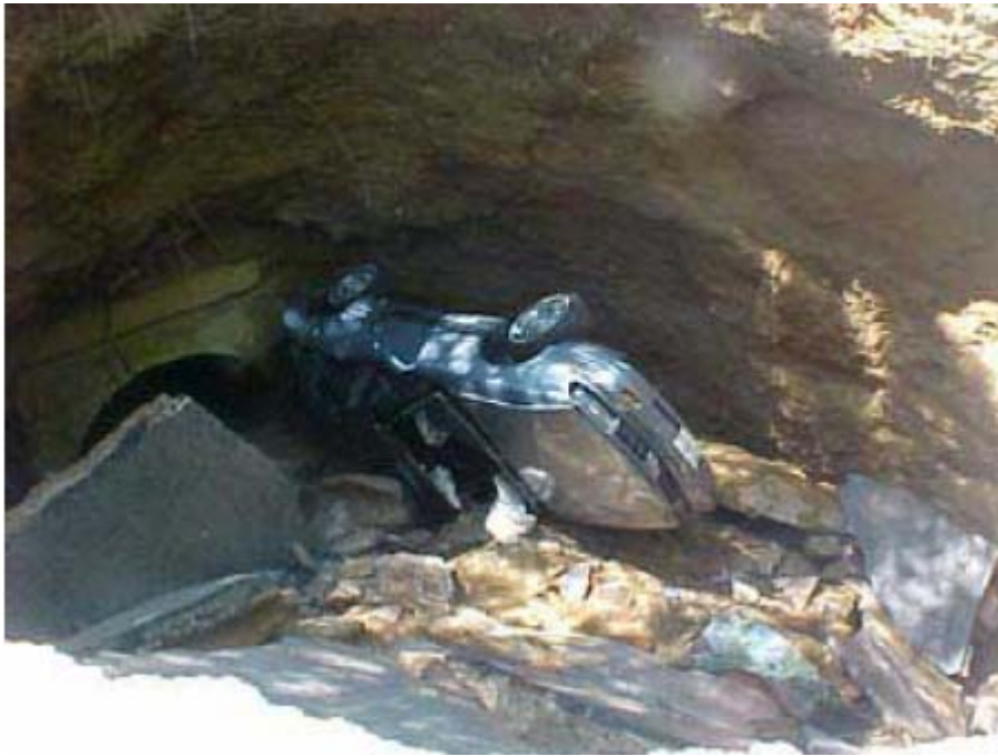
FIGURE 4 : Cratère dans la chaussée à Owings Mills Mall, Baltimore, Maryland
